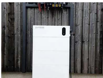
Buitenopstelling tegen de gevel
