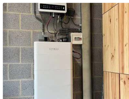
In de garage met Solis-omvormer
