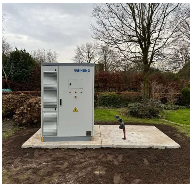
Batterijkast op een betonnen fundering, kabels ondergronds ingevoerd
