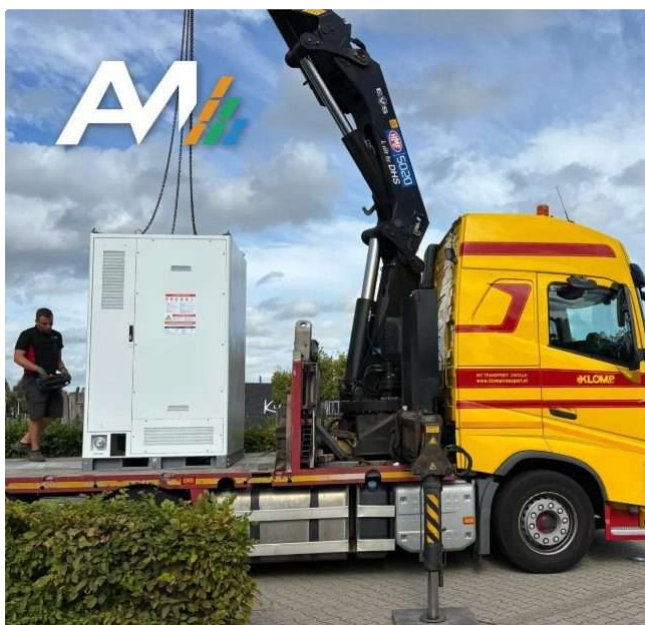
Batterijkast voor buiten, met de kraan op zijn plek gezet
