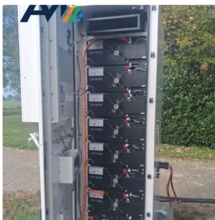
Van binnen: modules en bekabeling
